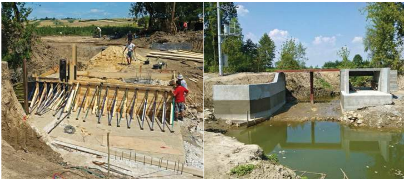
Fot. 3 Od lewej: deskowanie pionowych ścian kanału napływowego, jaz po ukończeniu betonowania
